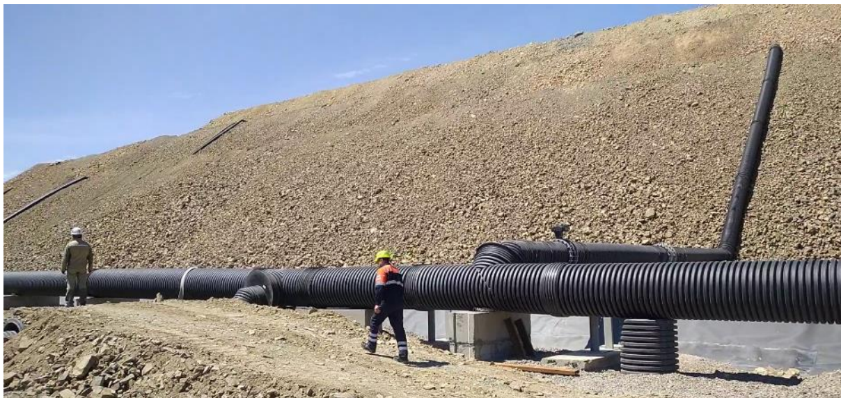
Рис.9 ПКВ-2. Коллектор подачи воздуха
