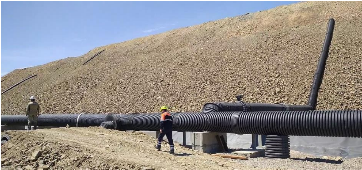
Рис.9 ПКВ-2. Коллектор подачи воздуха
